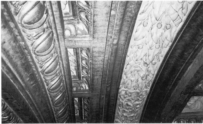
Fig.7 – Ss. Ambrogio e Carlo al Corso: tribuna, dettaglio della volta. A sinistra, il "contr'arco con ovoli" sovrapposto al "mezz'arco" a cassettoni; sulla destra, il "giro del festone di lauro" (AALR, Liber Instrumentorum..., 57, ff.9v-11v)
